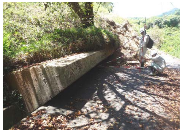
斜面崩壊末端部 土塊押し出しによる擁壁の倒壊
