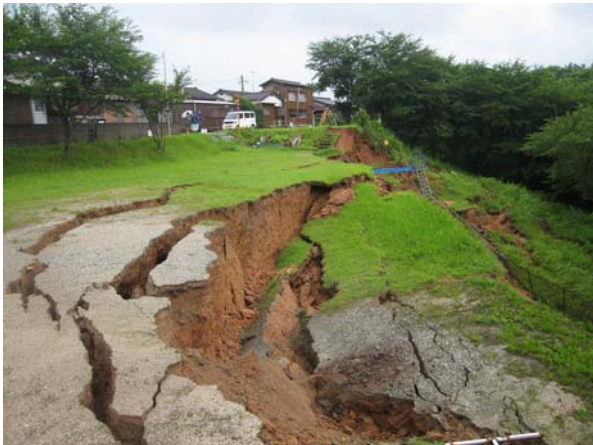
頭部の滑落崖 (落差約 3m)
