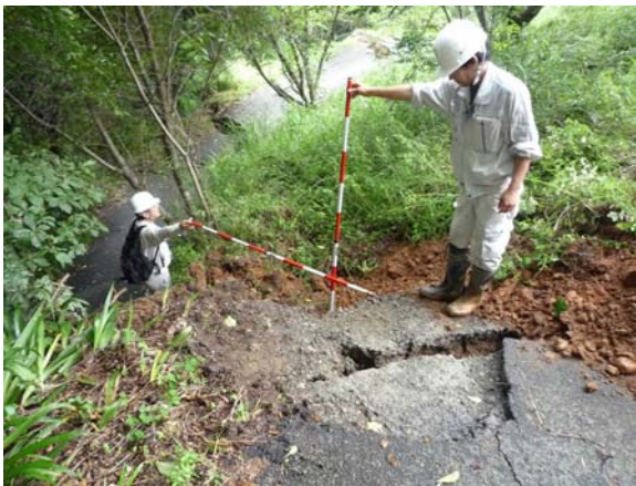
斜面崩壊中央部 土塊移動に伴い上段町道が切断・落差形成
