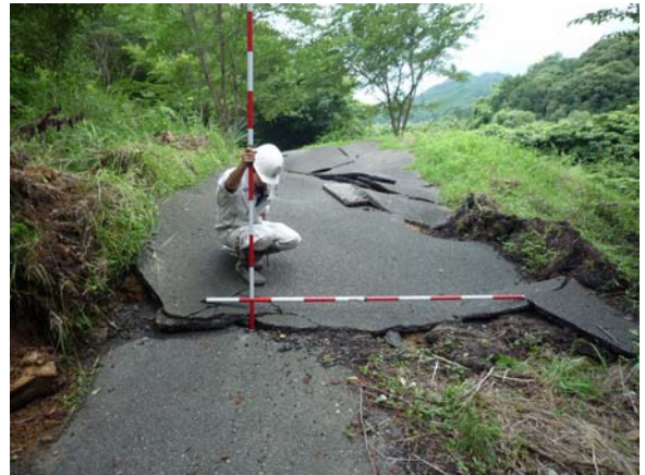
斜面崩壊中央部 移動土塊による上段町道の破損
