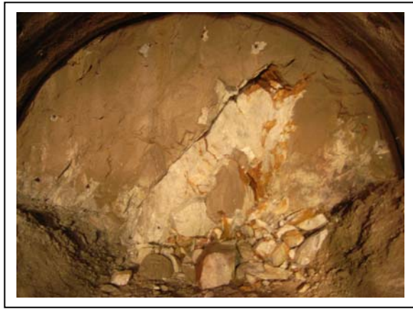
写真-3 崩落状況
