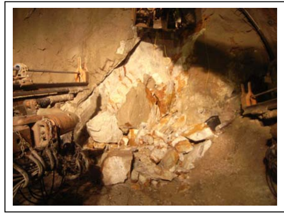
写真-4 崩落状況 (近景)
